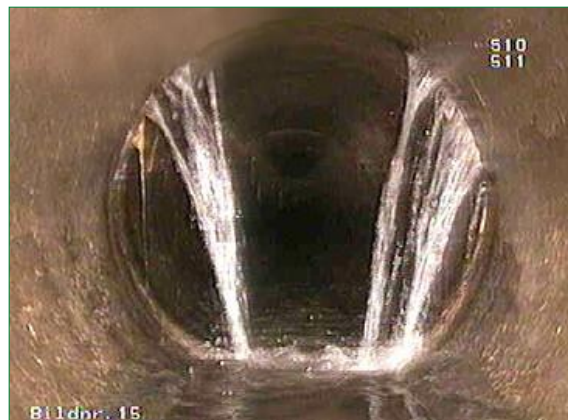
Bild 6: Fremdwasserzulauf im undichten Kanal
